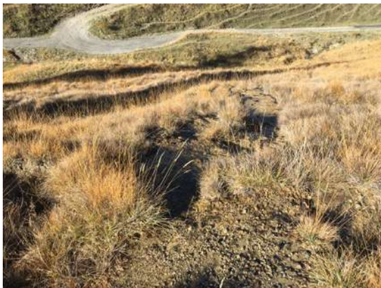
Stellenweise oberflächlich fließendes Wasser und Mineralausfällungen (unten und im Bildzentrum).
